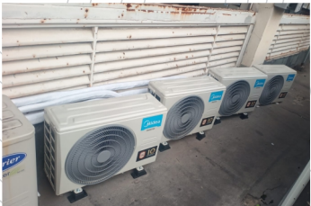
Serviços de climatização de ambientes e refrigeração.
